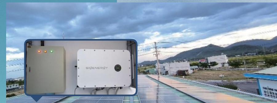
ベトナム工場 52 MW PV 容量 100 MW AC 出力
