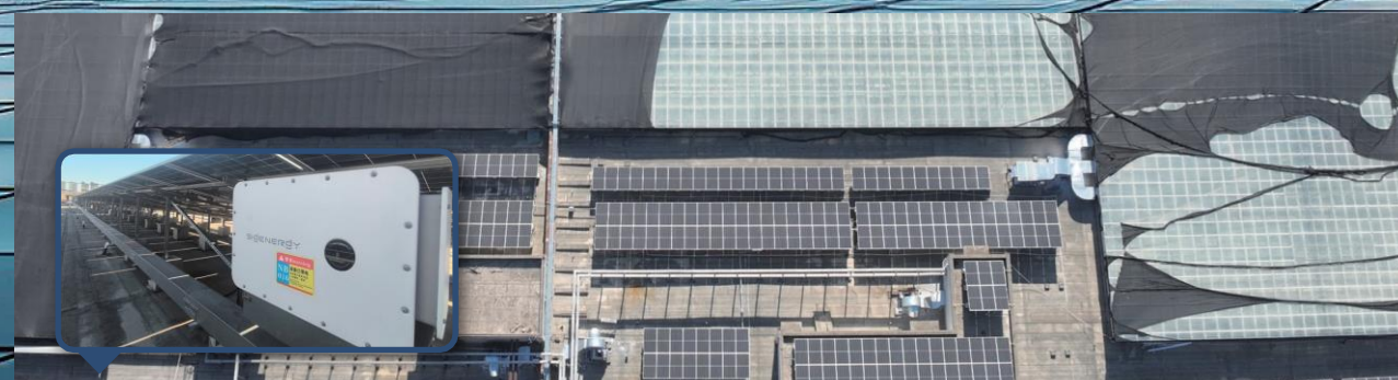
工場 2.7 MW PV 容量 2.36 MW AC 出力
