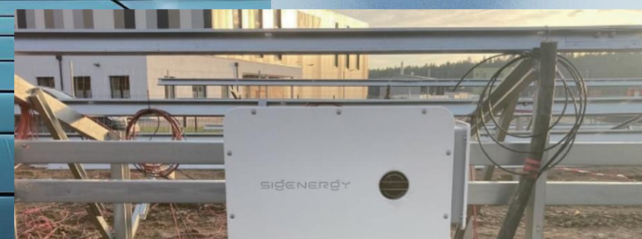
ベトナム工場 1.1 MW AC 出力
