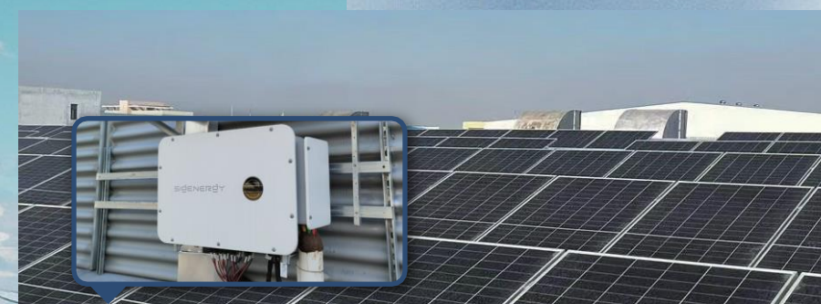
工場 1.6 MW PV 容量 1.6 MW AC 出力
