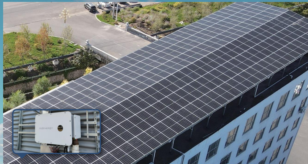
リチウム電池セパレータ製造 5.0 MW PV 容量 4.2 MW AC 出力
